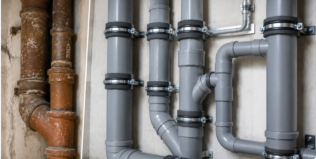
Links alt, rechts neu: Moderne Rohrsysteme sorgen für mehr Komfort.
